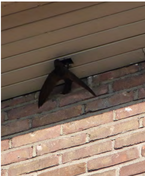
Gierzwaluwsteen weggewerkt in dakrand
